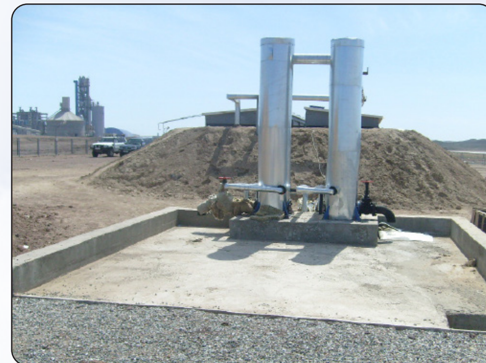
Общий вид запущенного в эксплуатацию оборудования ТОО «Эйкос» по очистке бытовых стоков
